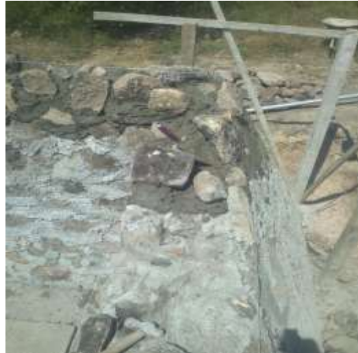
Tanque de almacenamiento
