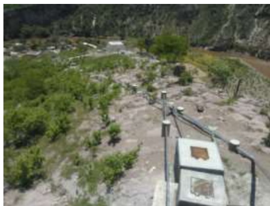
Cajas de valvulas y Atraques
