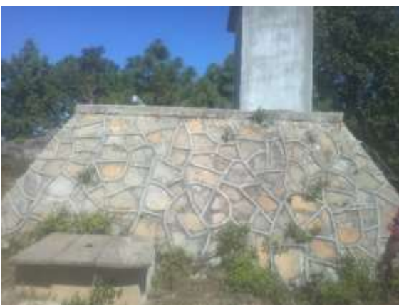
Tanque de almacenamiento
